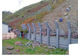
平成24年10月斜面崩壊状況
