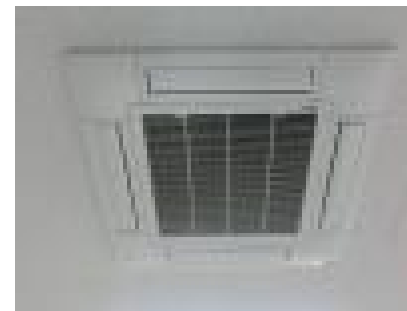
エアコン室内機
