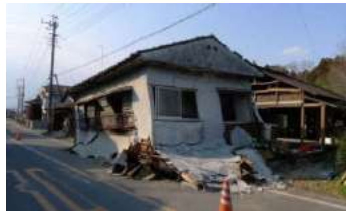
揺れによる被害
