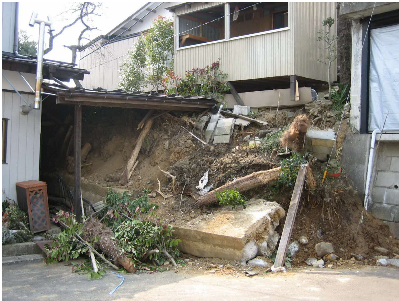
盛土箇所下端部の崩壊状況
