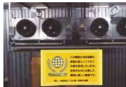
▲ノンフロン冷媒を使用した冷蔵冷凍設備
