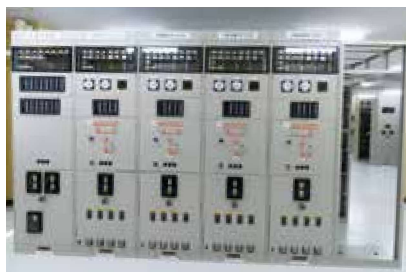
▲変電所向け回線制御盤
