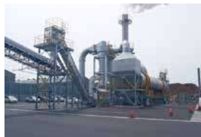
▲バイオマス発電プラント乾燥設備
