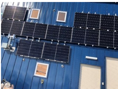
▲壁面太陽光パネル
