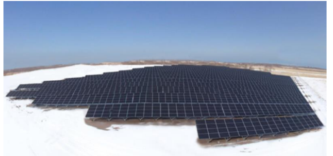
▲苫小牧太陽光発電所
